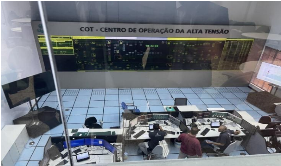
Figura 4 - Centro de Operação de Alta Tensão – COT
