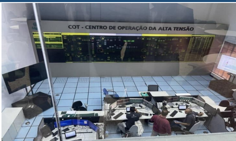
Figura 4 - Centro de Operação de Alta Tensão – COT
