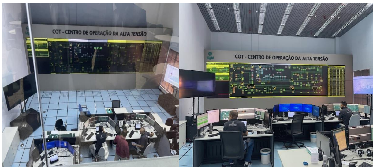
Figura 5 - Centro de Operação da Alta Tensão – COT
