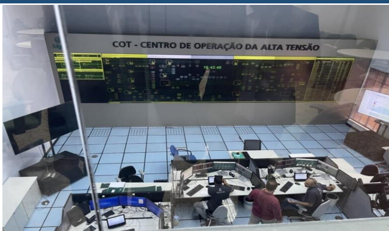
Centro de Operação de Alta Tensão – COT
